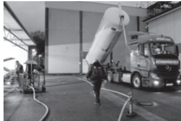
Ein Silofahrzeug liefert das Kies-Wassergemisch an, das dann in die Becken eingespült wird.
