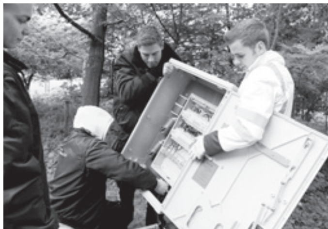
Tom Luttermann, Lars Merten, Thore Kayser und Sebastian Rohwer (v.l.n.r.) schließen gemeinsam einen Verteilerkasten an die Stromversorgung an.
