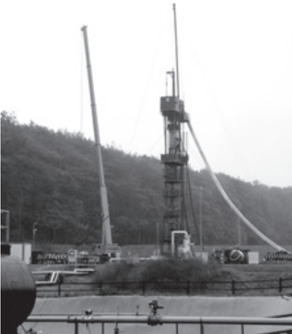
Mit Hilfe dieses Turms wurden die Sole-Rohre wieder aus der Erde entfernt.
