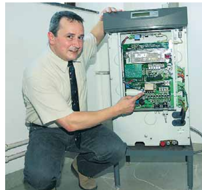
WhisperGen – ein Kleingenerator, der den üblichen Heizkessel ersetzen kann. Roger Mayer, Geschäftsführer SW Kiel Erzeugung GmbH, erklärt die kombinierte Wärme- und Stromerzeugung.
