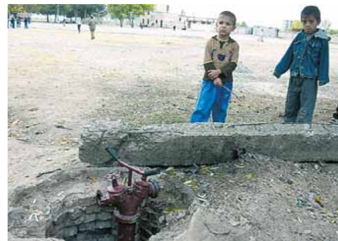
Der Standard der Wasserversorgung in Tadschikistan kann mit den biesigen Verhältnissen kaum verglichen werden. Selbst in der Hauptstadt Duschanbe sind die Anlagen stellenweise in einem desolaten Zustand.
